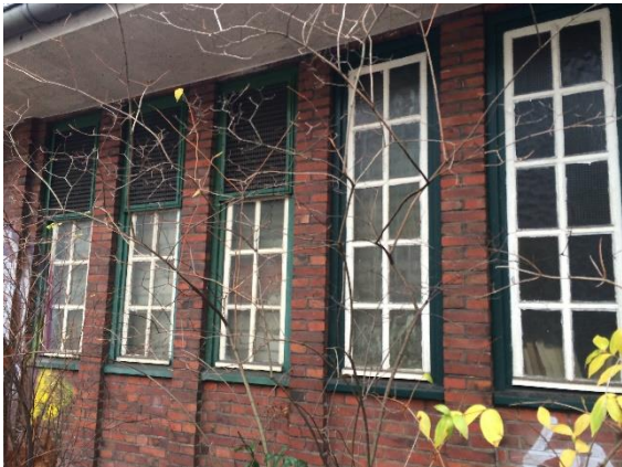
Zu 2. Trafohaus von Borsteler Chaussee – zugemauerte Fenster zu Trafo (Foto J. Bönig 2018)
