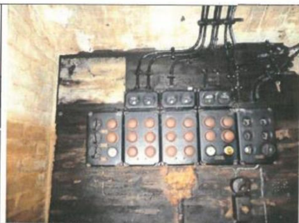
Bild 2: alte Elektrik, ohne Analyse unterstellt mit asbesthaltigen Pappen
